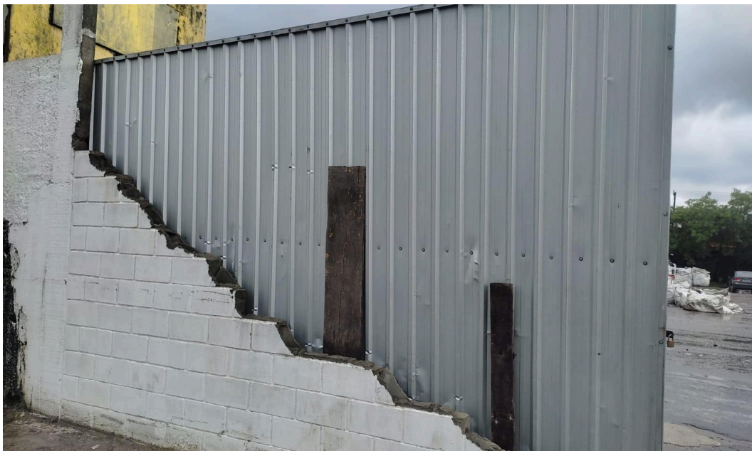
Figura 10 - Portão lateral danificado
